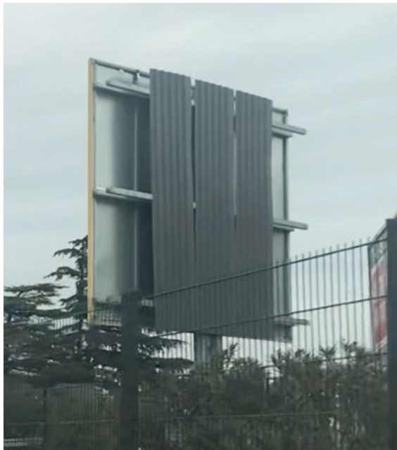
Défaut d'aspect soigné
